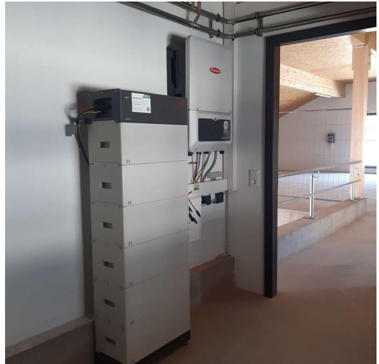
Bild: PV-Wechselrichter mit Speicher
