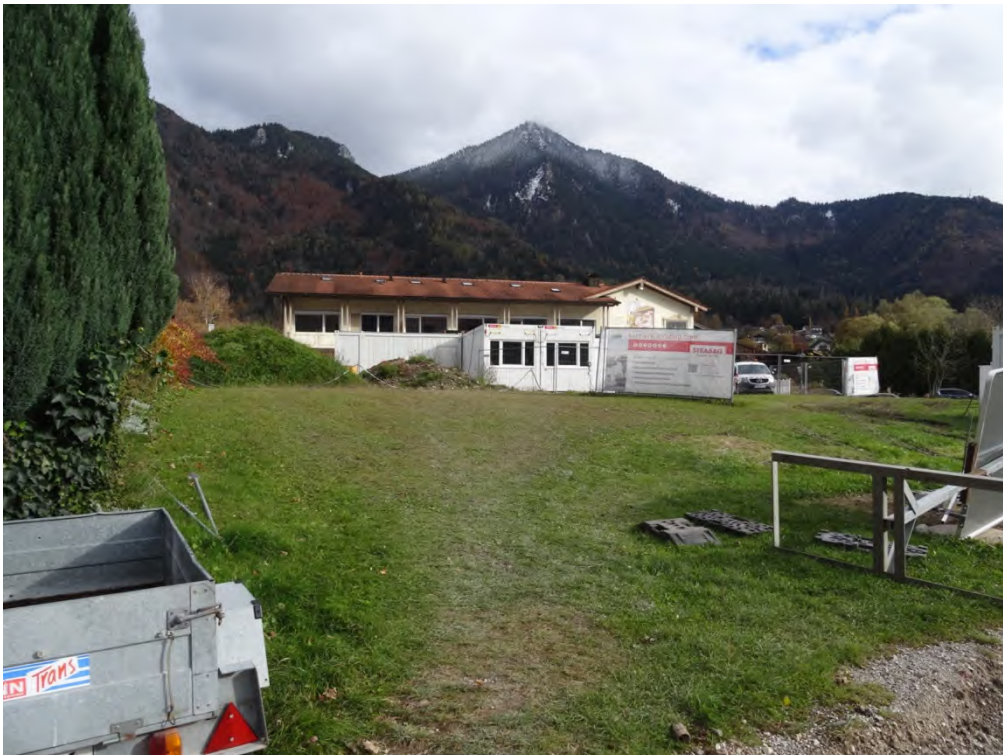
Abbildung 8: Rasenfläche im Westen des Plangebietes (Blick von Westen), im Hintergrund der Gebäudekomplex mit der davor liegenden Baustelleneinrichtungsfäche.
