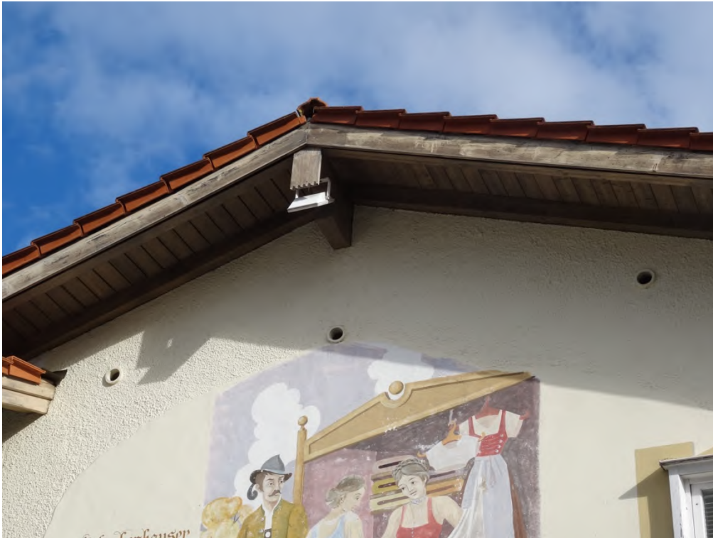
Abbildung 11: Westfassade des Gebäudekomplexes mit potentiellm Fledermausquartier hinter dem Windbrett sowie Einflugmöglichkeiten in den Dachbereich über Lüftungsöffnungen und den offenen Giebel (rote Pfeile).
