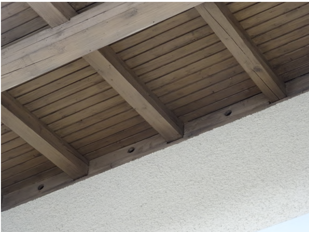
Abbildung 12: Potentielle Einflugmöglichkeiten für Fledermäuse und Gebäudebrüter in den Dachbereich an der Westfassade des Gebäudekomplexes (roter Pfeil).
