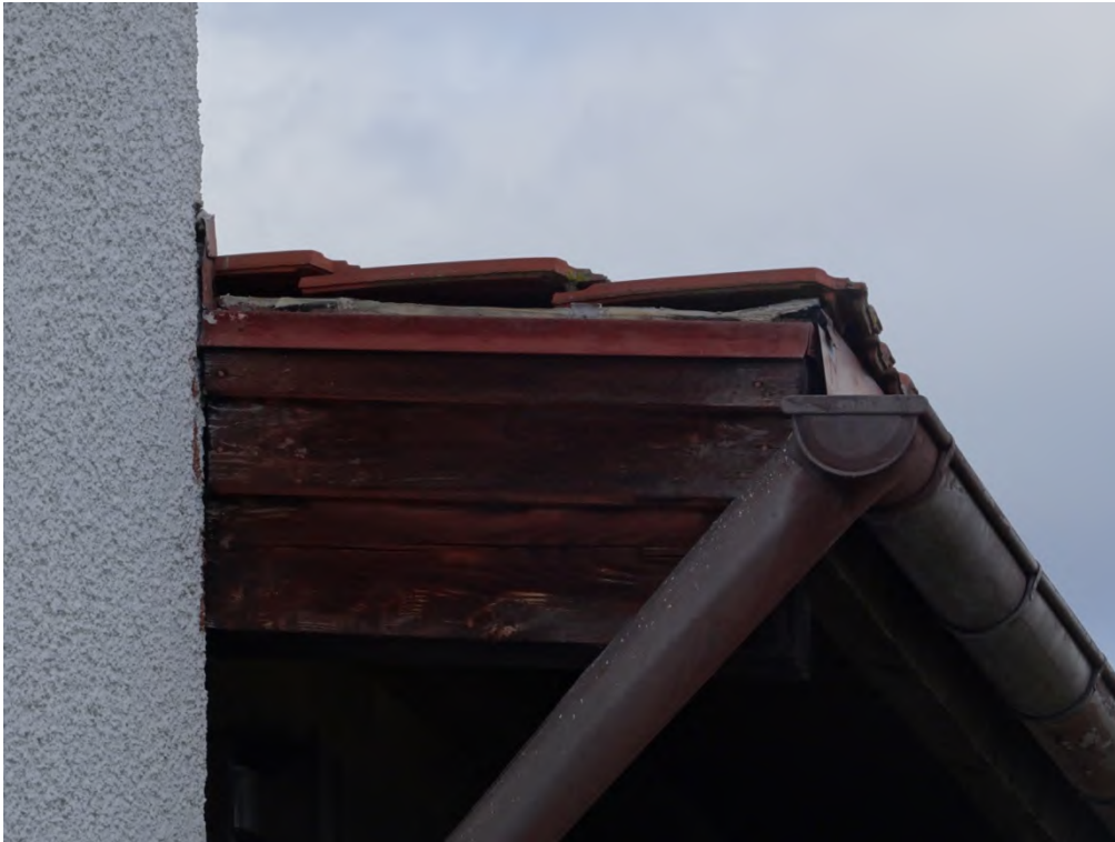
Abbildung 13: Potentielle Einflugmöglichkeiten für Fledermäuse in den Zwischendachbereich unter den Dachziegeln an der Ostseite des Gebäudekomplexes (roter Pfeil).
